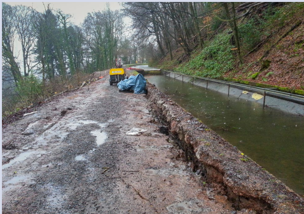
Y tir yn llithro i ffwrdd oddi wrth leinin concriid y gamlas ger Pont Tod.
